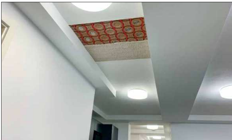
Auf der ganzen Fläche wurden Natur-Klimadecken aus Hochleistungs-Lehmmodulen installiert. Eine Schauffläche zeigt den Systemaufbau.
