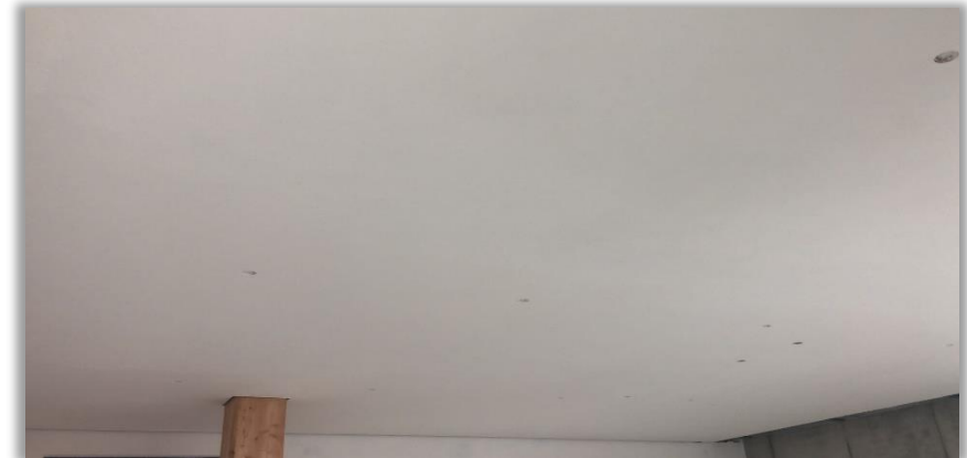
Fertige Oberfläche in Q2 Oberflächengüte Generell in Q2 zwecks Oberflächengröße bleiben!
