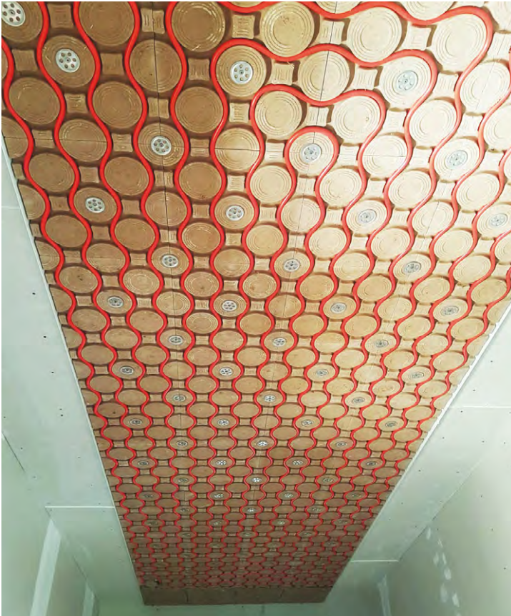
1 Wassergeführte Lehm-Kühldecke vor der Oberflächenbeschichtung.
