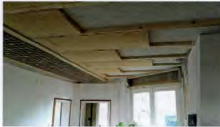
Da sich die Decke direkt unter dem Flachdach befindet, wurde eine Holzfaserinndämmung angebracht [© ArgillaTherm]
