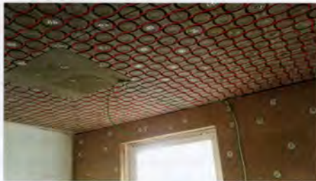
Zunächst wurden alle Module provisorisch in der Mitte angeschraubt und anschließend die Ecken fixiert, dann wurden die Rohrleitungen in der Rillenstruktur verlegt [© ArgillaTherm]
